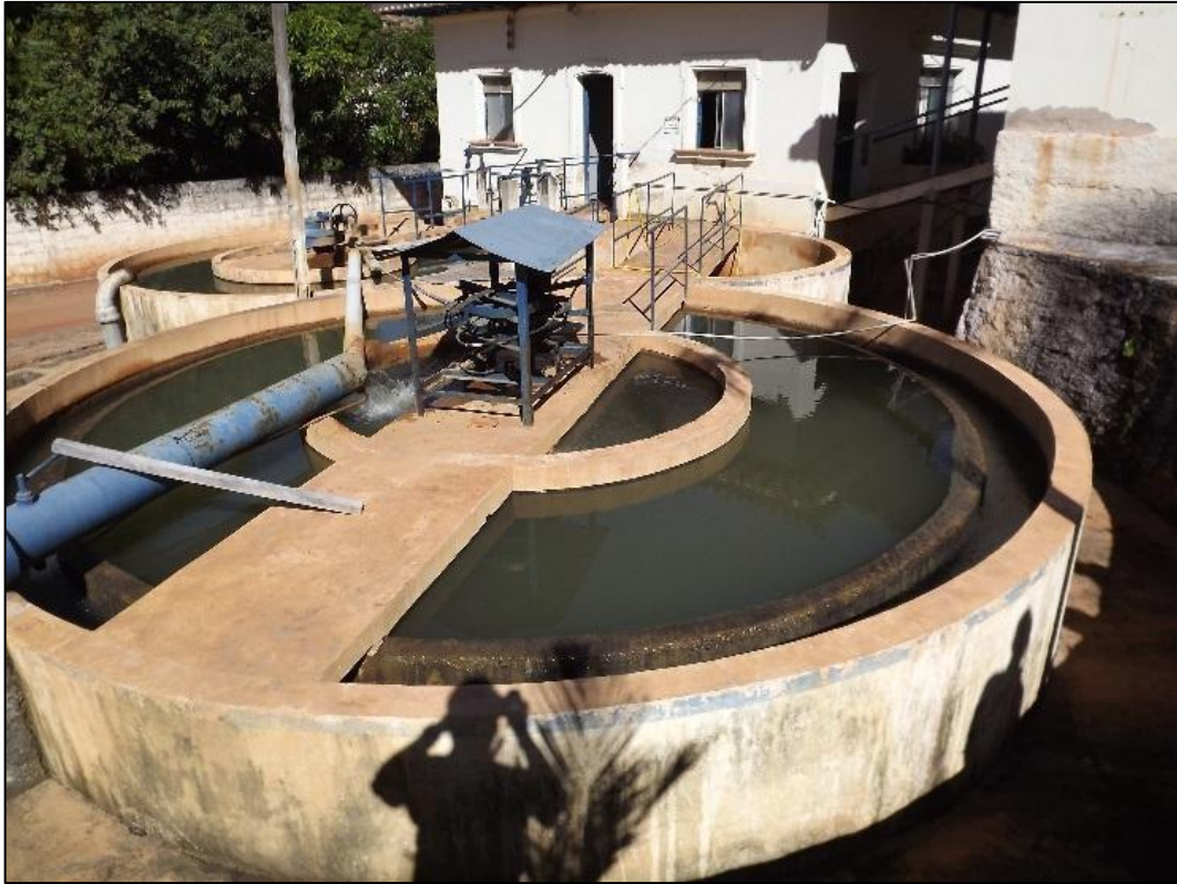
Figura 21 - Vista geral do floculador (parte interna) e decantador (parte externa)
