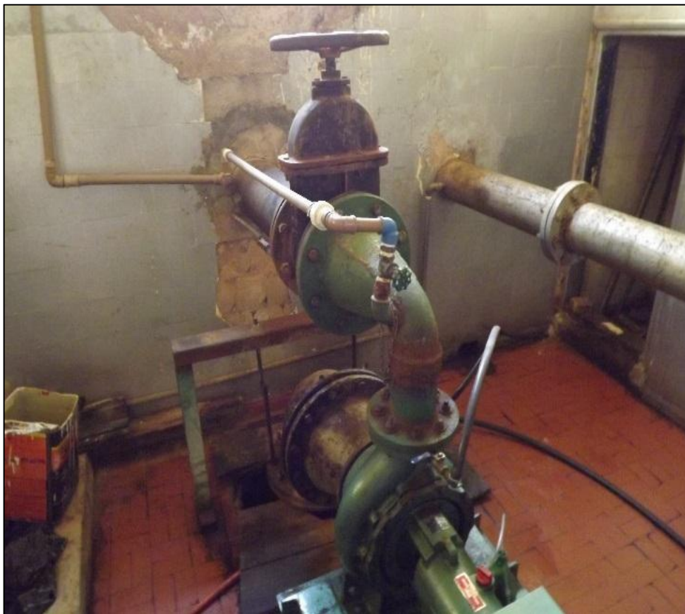
Figura 38 - Detalhe de conjunto motobomba na EEAT
