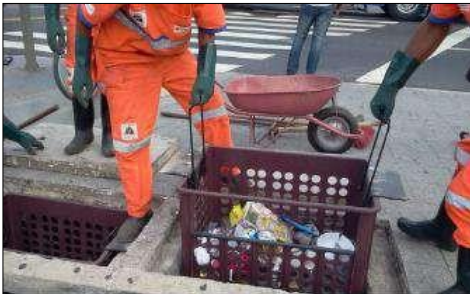
Figura 118 - Cestas acopladas às bocas de lobo
