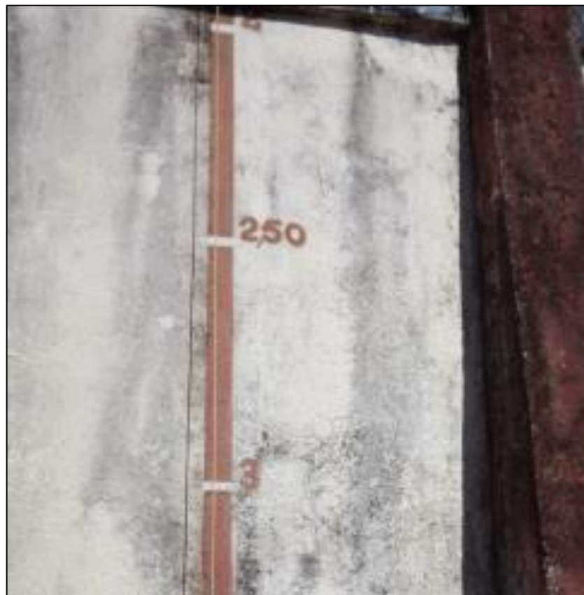
Figura 44 - Detalhe do Macromedidor de nível do RAP Central
