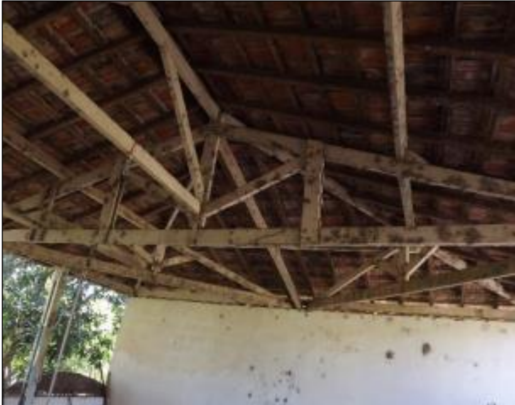
Figura 63 - Detalhe dos microorganismos na cobertura da EEE Conceição
