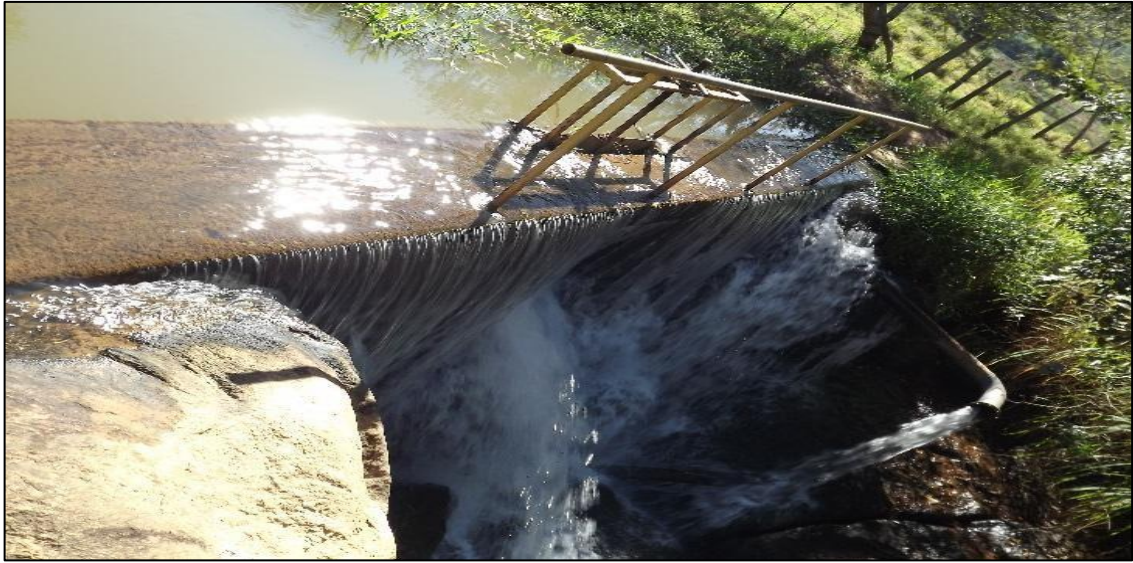
Figura 16 - Detalhe da barragem de nível
