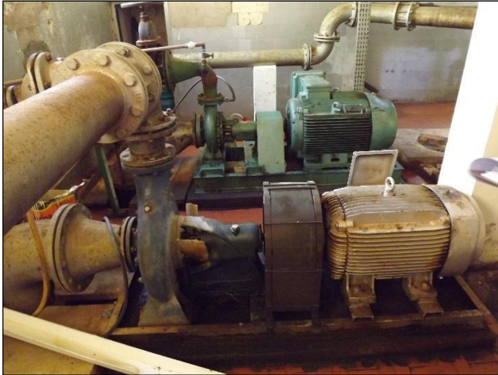
Figura 37 - Conjunto motobomba na EEAT
