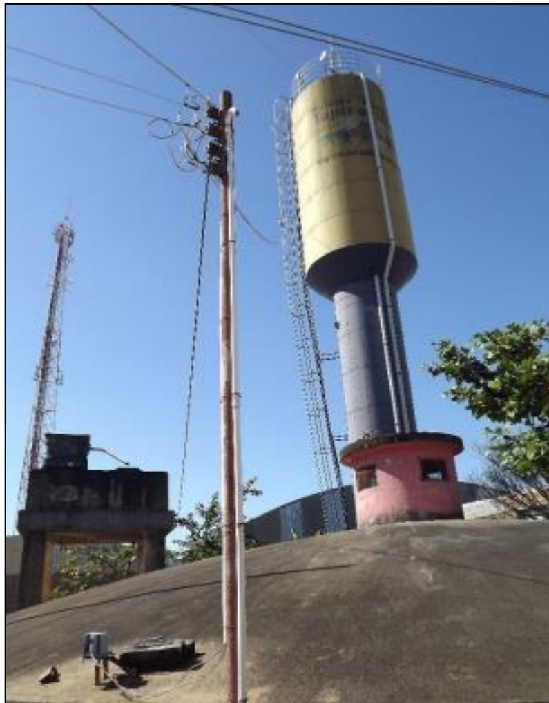
Figura 45 - SER Central (á frente) e REL Central (ao fundo)
