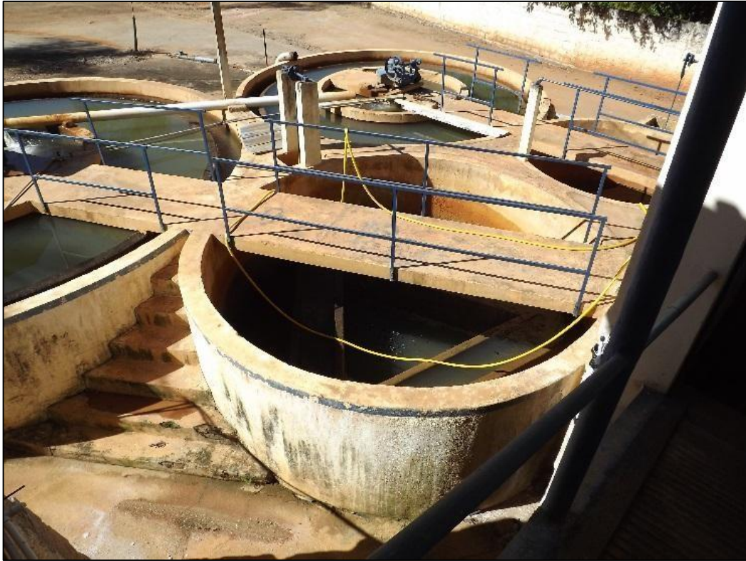
Figura 23 - Vista geral dos filtros na saída do conjunto floculadores decantadores
