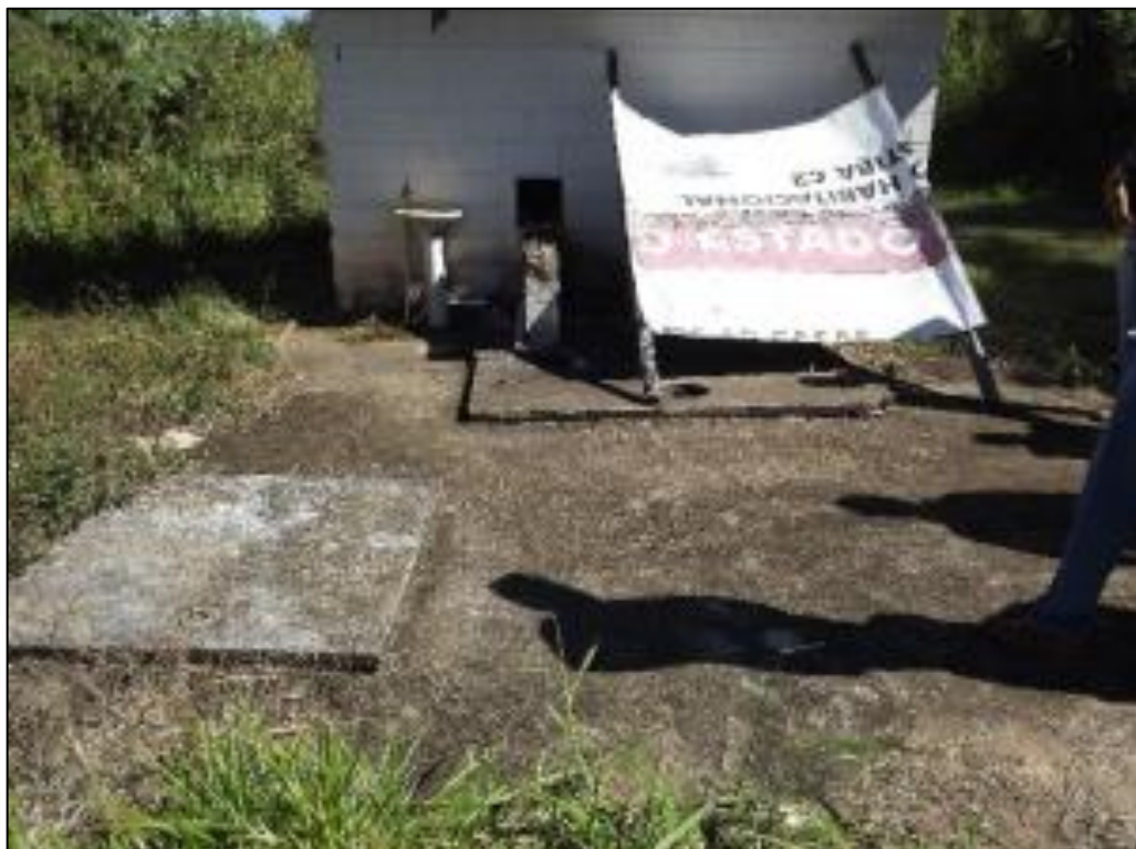
Figura 64 - Vista geral do poço de sucção da EEE Soledade
