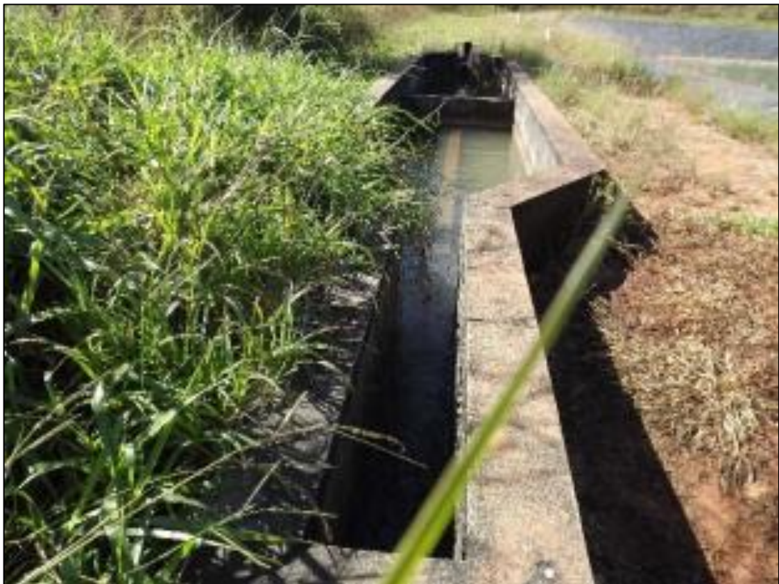
Figura 72 - Vista geral do tratamento preliminar da ETE Soledade
