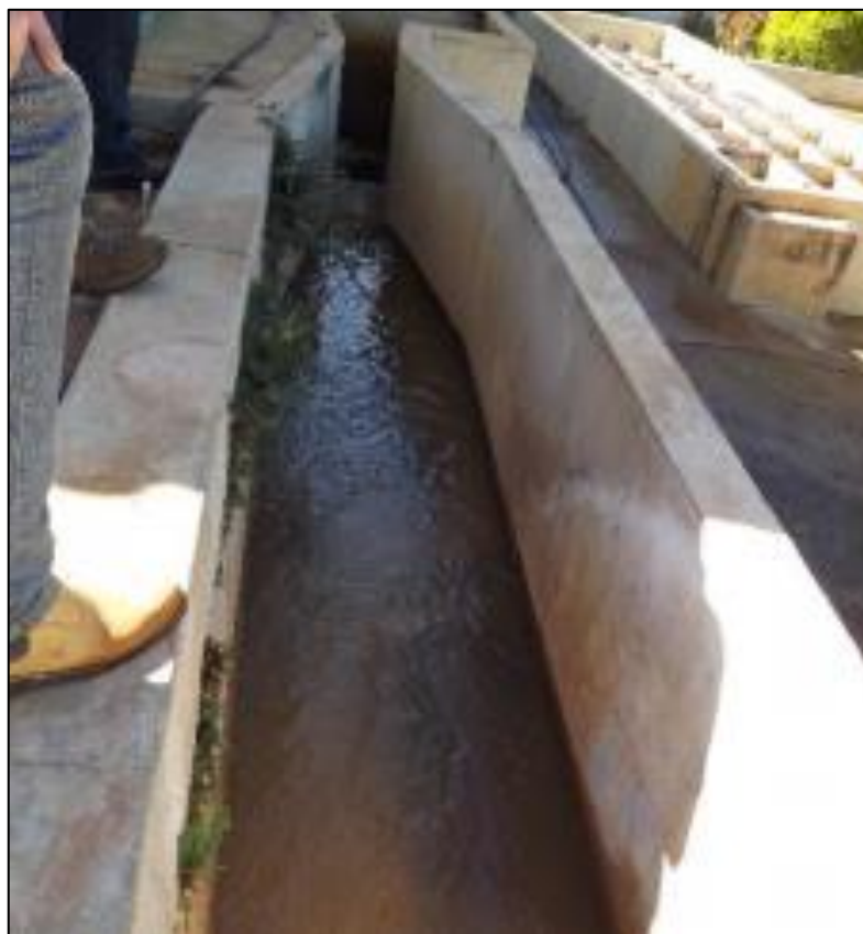
Figura 30 - Vista geral da Calha Parshall seguida do tanque de acumulação
