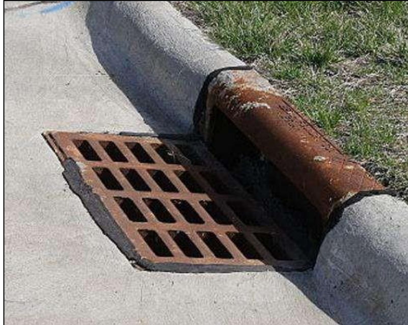
Figura 119 - Gradeamento em boca de lobo na sarjetaDiretrizes para o controle de escoamentos na fonte
