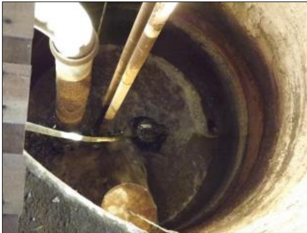
Figura 61 - Detalhe do poço de sucção e bomba submersa na EEE Conceição
