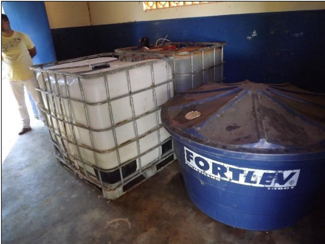
Figura 25 - Detalhe do armazenamento de hipoclorito de sódio para pós - cloração
