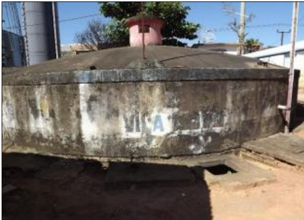
Figura 43 - Vista Geral do SER Central
