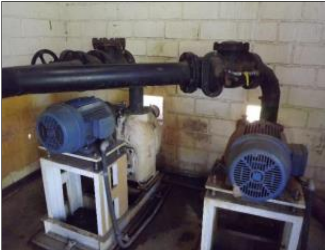
Figura 65 - Detalhe dos dois conjuntos motobomba da EEE Soledade
