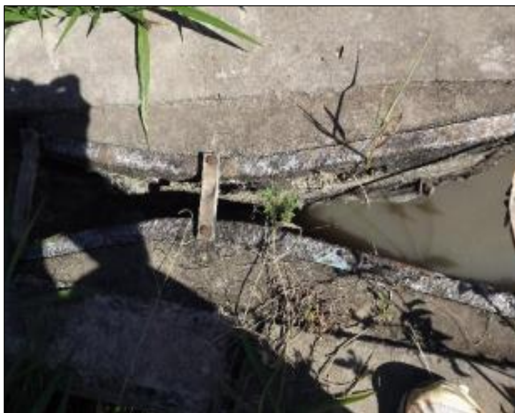
Figura 68 - Detalhe da Calha Parshall
