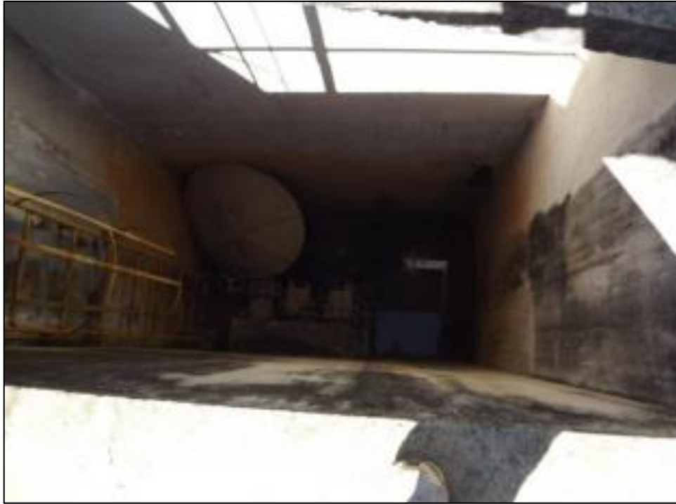
Figura 35 - Detalhe do sistema de retrolavagem e decantadores com problemas de acesso
