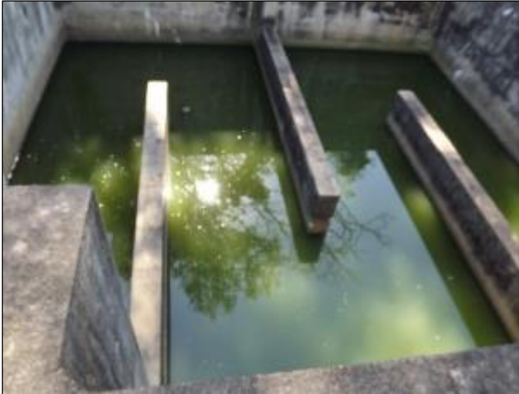
Figura 75 - Detalhe do tanque de contato para desinfecção
