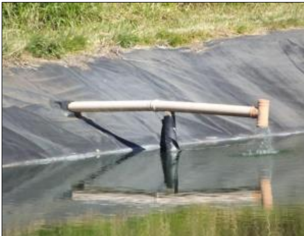
Figura 70 - Tubulação de entrada na lagoa facultativa da ETE Conceição
