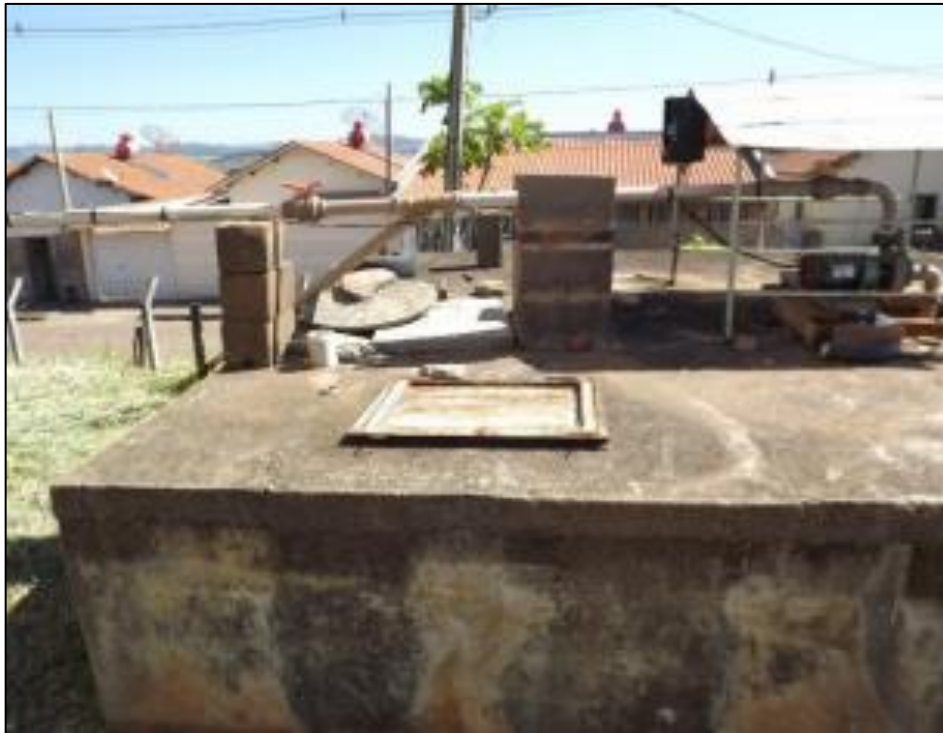
Figura 51 - Detalhe do sistema de reservação e elevatória para o RAP Renascer (desativado no momento)
