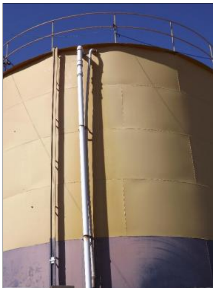
Figura 50 - Detalhe da tubulação de entrada do RAP Renascer
