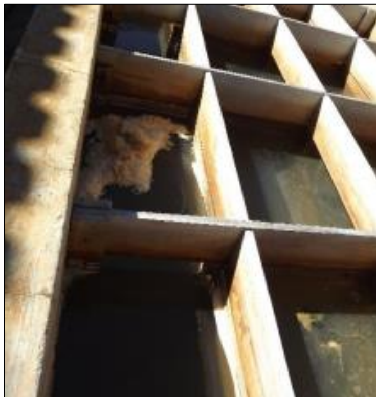
Figura 32 - Detalhe do floculador
