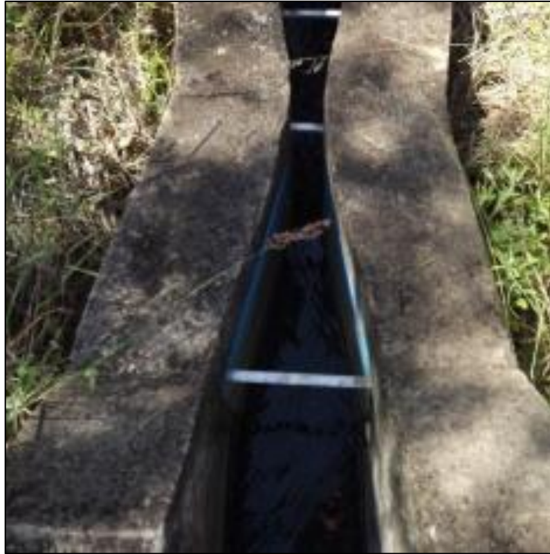
Figura 73 - Detalhe da Calha Parshall
