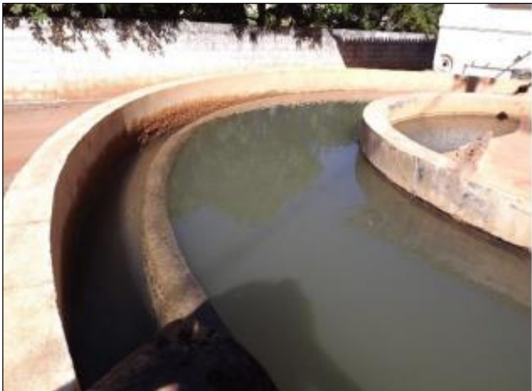
Figura 22 - Detalhe da tomada de água (camada externa) na saída dos decantadores
