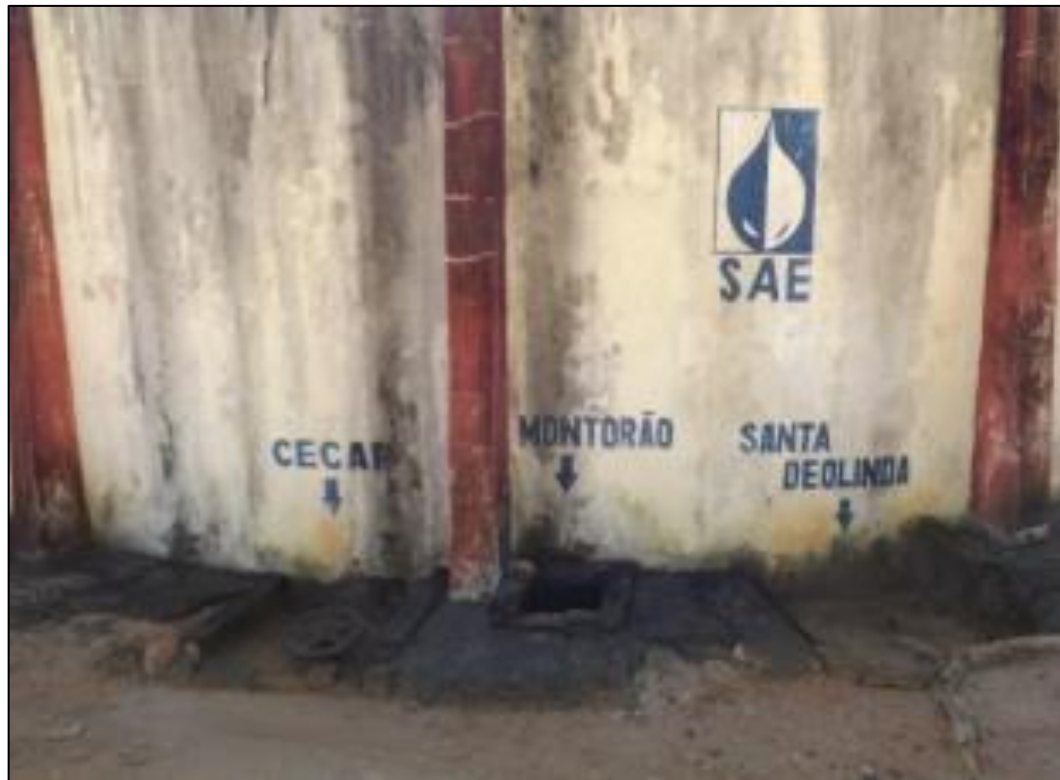
Figura 41 - Detalhe de demais saídas do RAP Central
