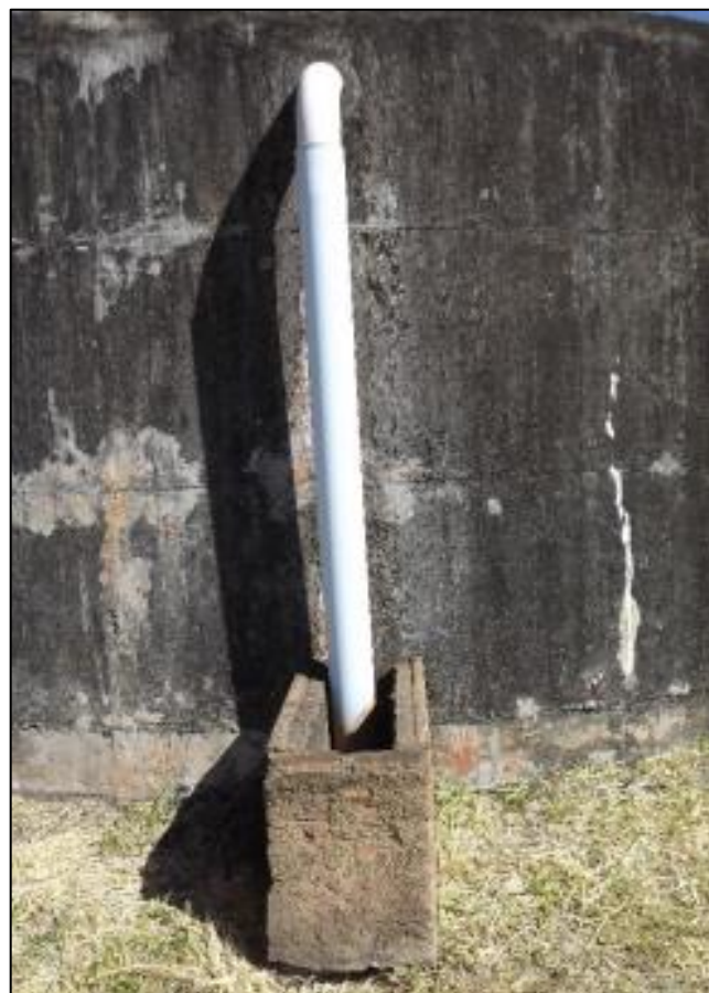
Figura 48 - Detalhe de tubulação de entrada do RAP Urbano Brochi
