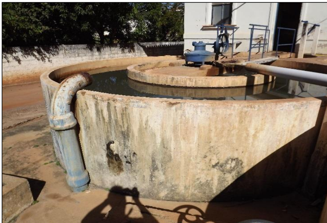
Figura 28 - Detalhe da adutora de ligação do módulo 2 quebrada
